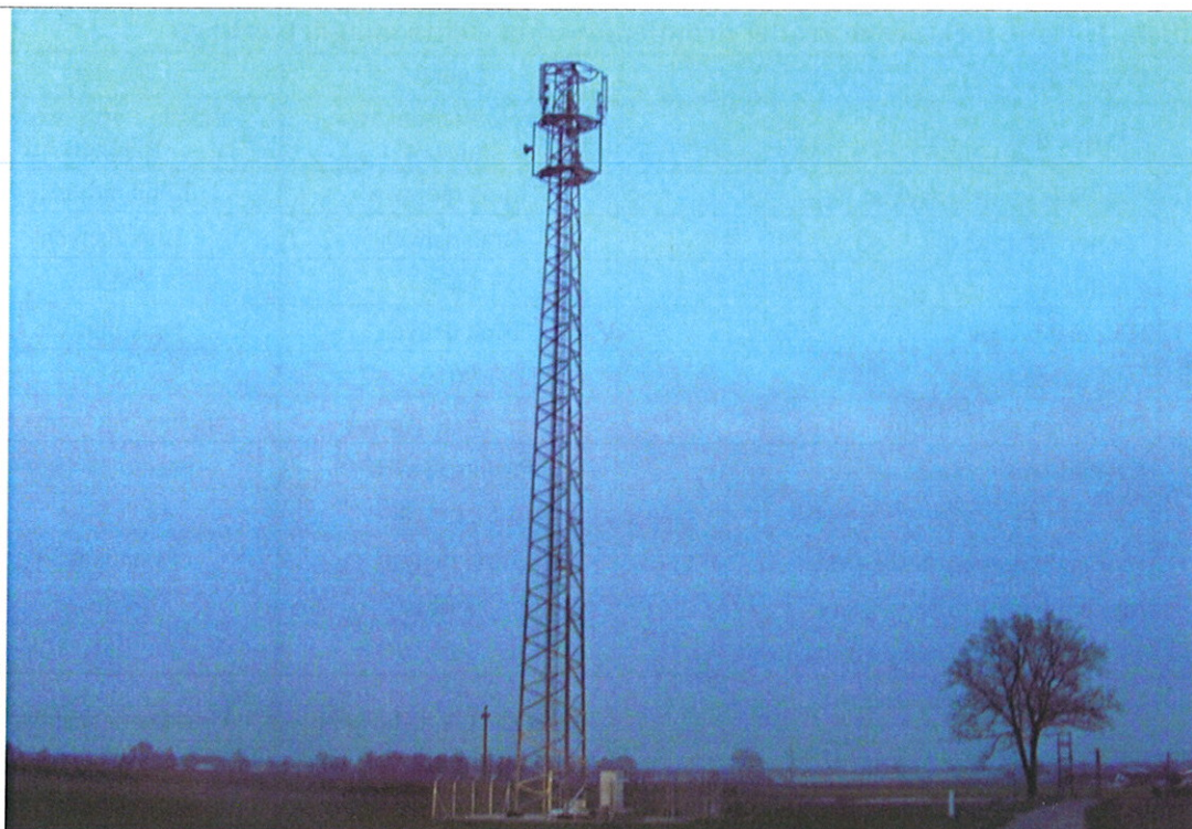
Fot. 1. OM OIK Kolonia / Nowa Wieś – widok wieży antenowej, na której zainstalowano anteny linii radiowych Emitel
