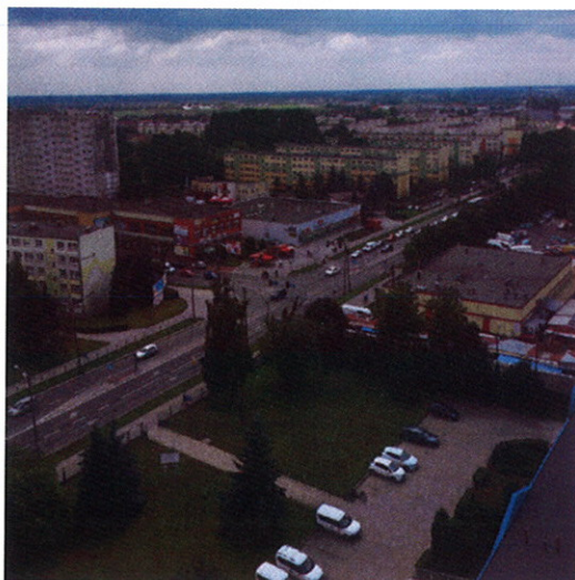
Fot.4 Widok na antenę sektorową na azymucie 175/177°
