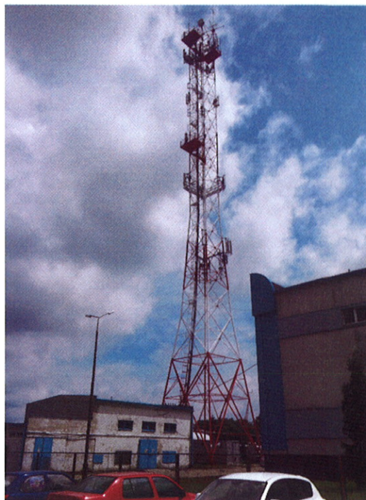
Fot.1. Stacja bazowa na wieży kratownicowej w Sieradzu
