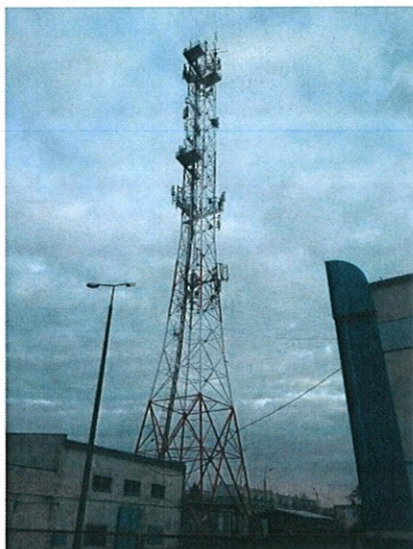
Widok obiektu wraz z zainstalowanym zespołem antenowym
