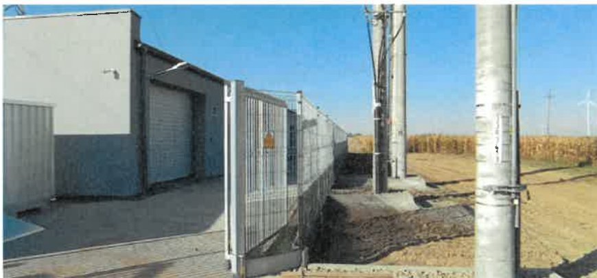
Stacja elektroenergetyczna 110/30 kV GPO Wójcice. Ogrodzenie zewnętrzne
