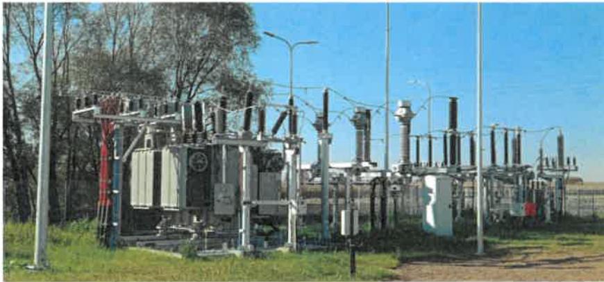
Stacja elektroenergetyczna 110/30 kV GPO Wójcice. Rozdzielnia 110 kV
