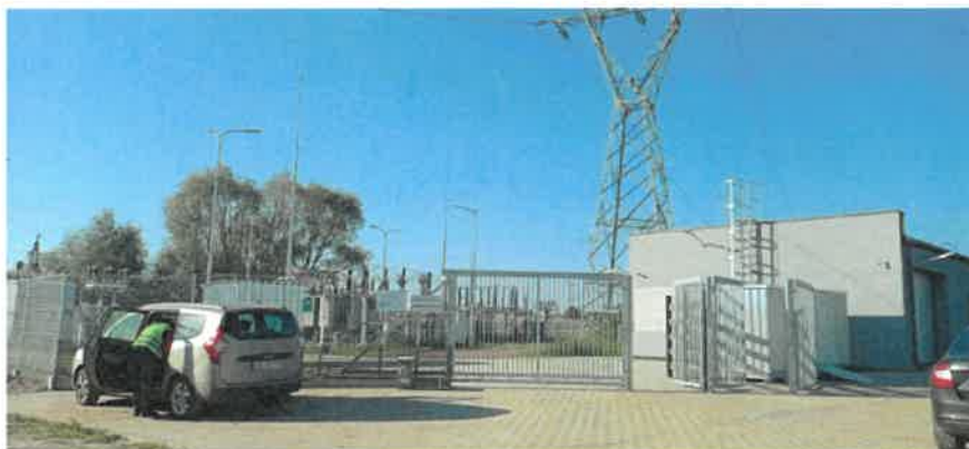
Stacja elektroenergetyczna 110/30 kV GPO Wójcice. Brama wjazdowa
