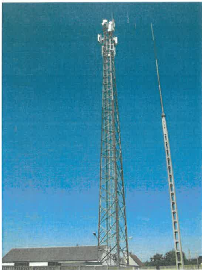
Zof. nr 1: Widok ogólny instalacji radiokomunikacyjnej.
